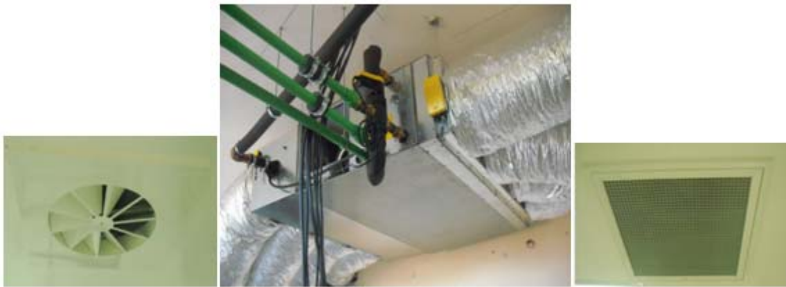
Équipements du système de conditionnement d'air du laboratoire : Groupe froid, centrale de traitement d'air et accessoires
