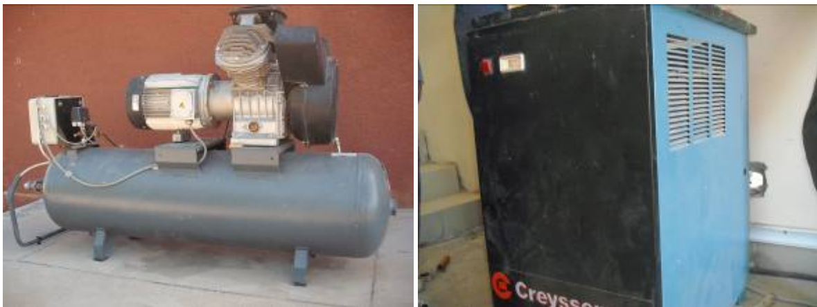
Compresseur d'air et séchoir
